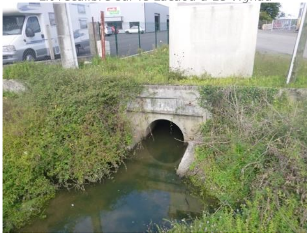
Lit busé sur le ruisseau de Péré à Saint-Sever
