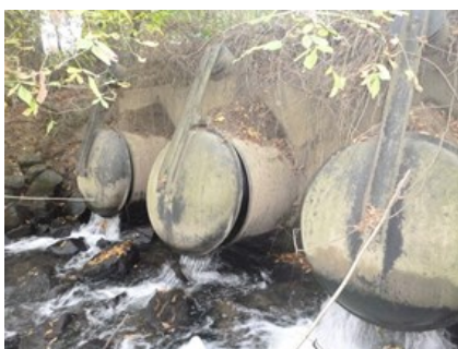
Porte anti-flots sur le ruisseau du Martinet
