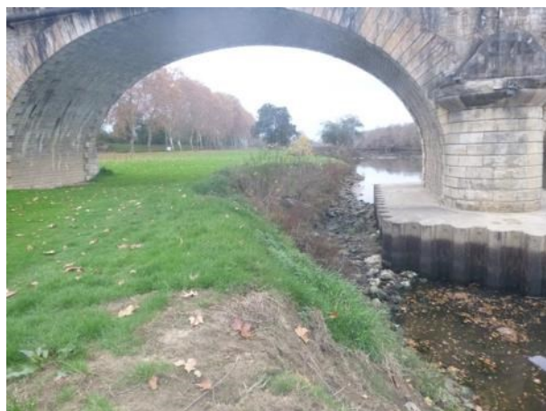
Erosion de berge sur l'Adour à Dax
