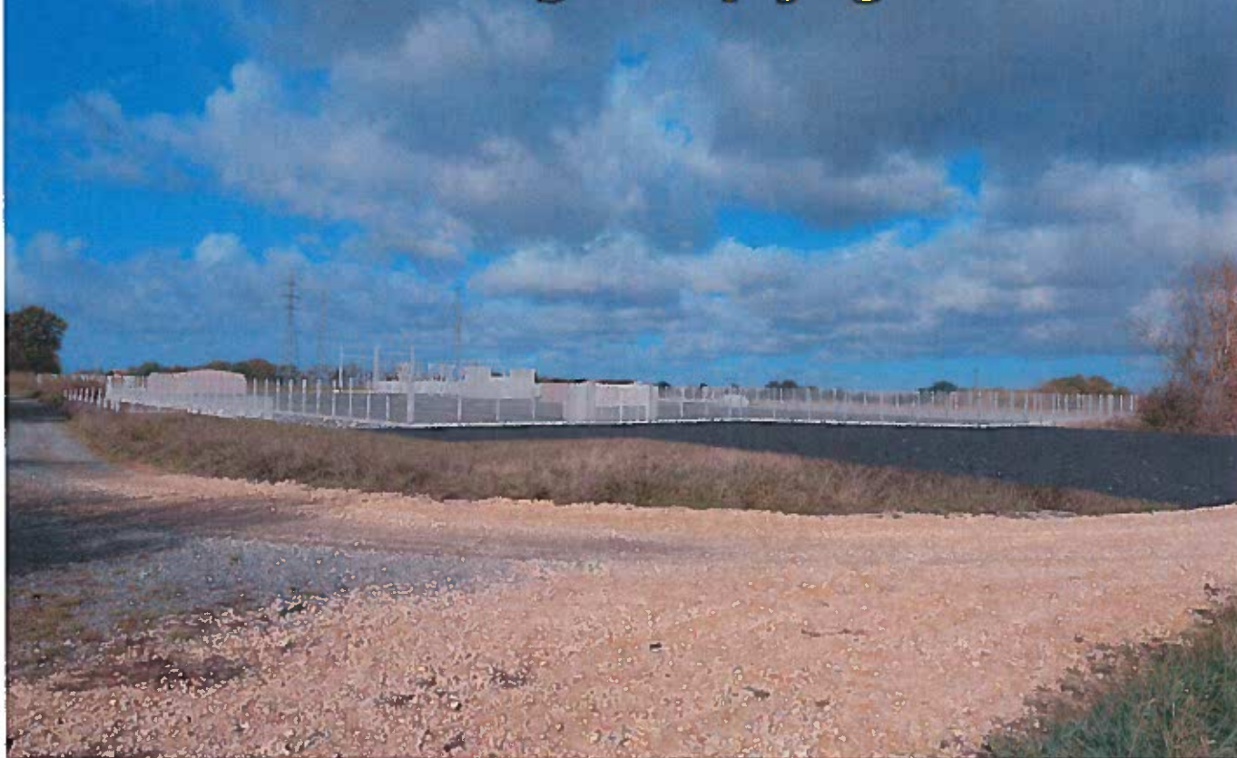
Poste SRD sans aménagement paysager
