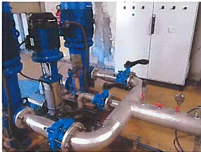
Station de pompage rénové en mai 2017
