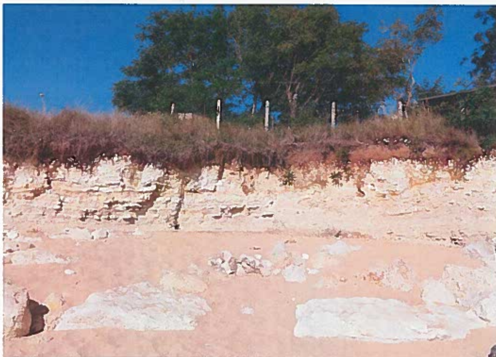
Photo 3 : Vue de la falaise à conforter
