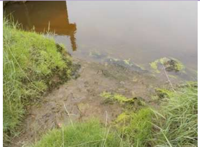
Vue de l'érosion en amont du pont
