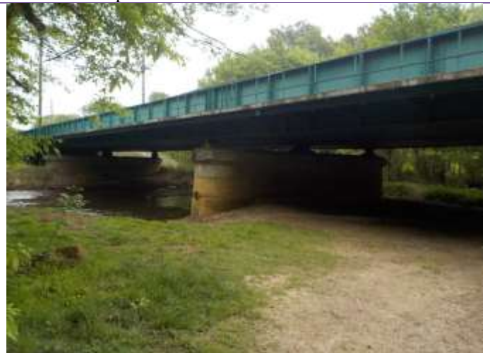
Le chemin piétonnier passe sous le pont de la voie SNCF. Il est de largeur suffisante pour le passage de la faune terrestre.
