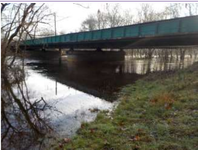
En crue, le passage sous le pont est inaccessible.
