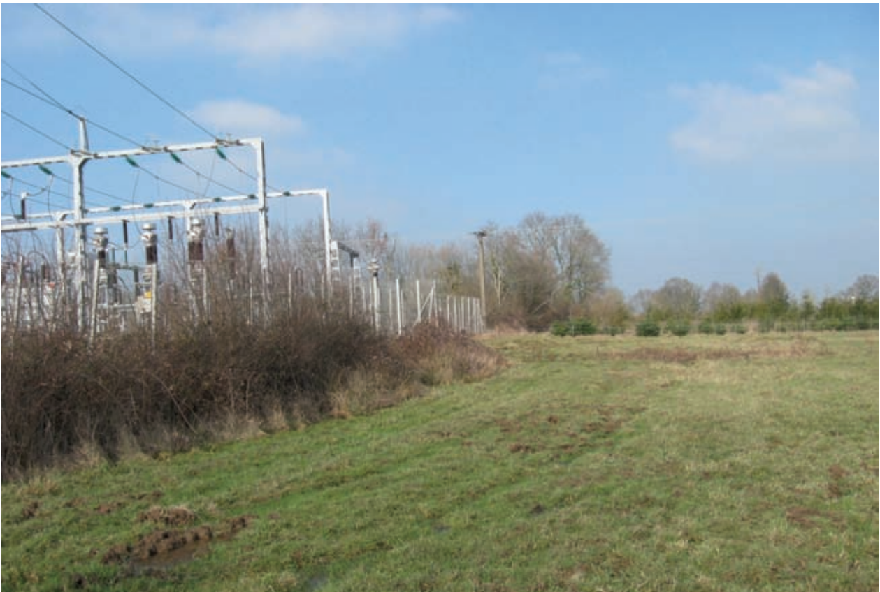
4 VUE SUR LA PARTIE EST DU POSTE EXISTANT (AVEC UNE MARE ET LE FOSSÉ À PROTÉGER)
