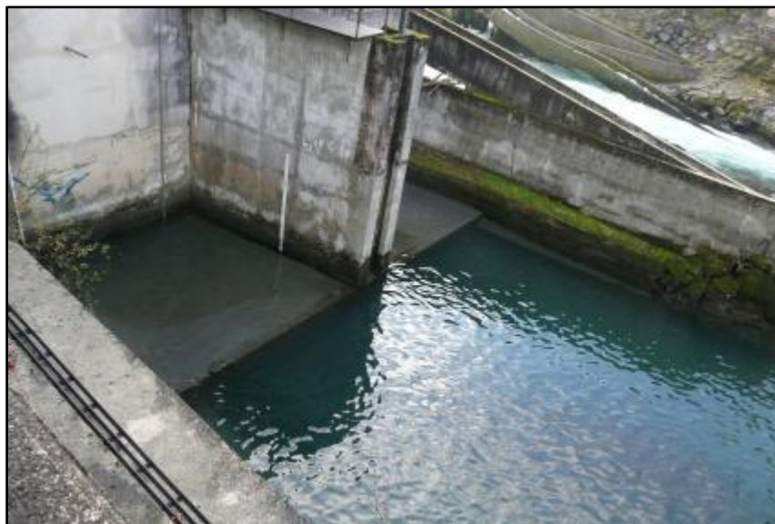
Vue de la sortie des turbines (hors fonctionnement)
