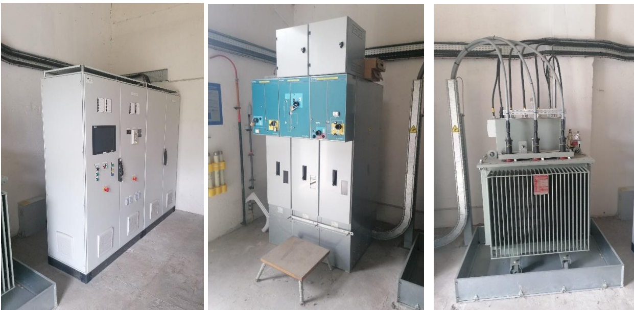
Figure 10: Installations électriques actuelles
