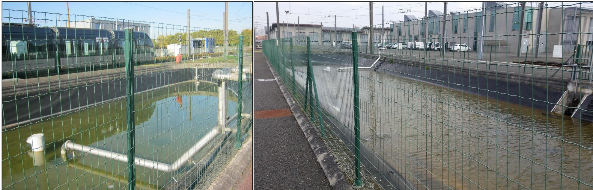
Figures 7 et 8 : Photographies des installations présentes au nord du bassin
