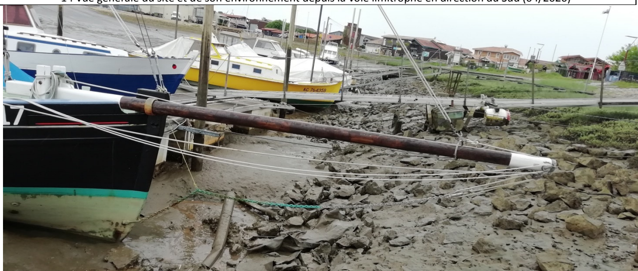
2 : Aspect général du perré et de la zone de travaux : vue en direction du Sud (04/2020)
