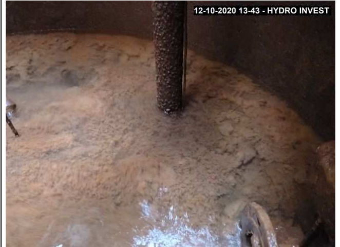
Photo N°20 Vanne fermée fuyarde d'un drain. Flocs de biofilm abondants au fond de l'ouvrage (bactéries du Fer)
