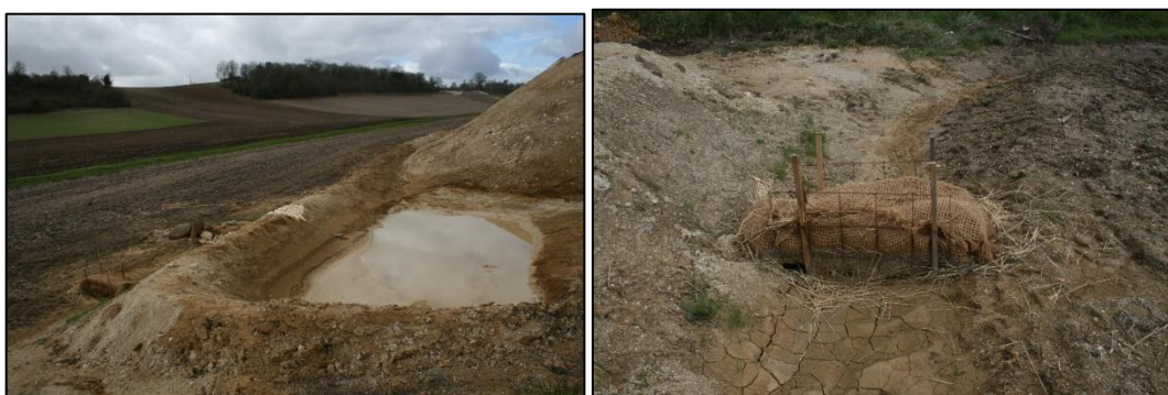
Figure 23 : Bassin de décantation temporaire des eaux de ruissellement en phase de chantier avec filtre à paille en sortie
