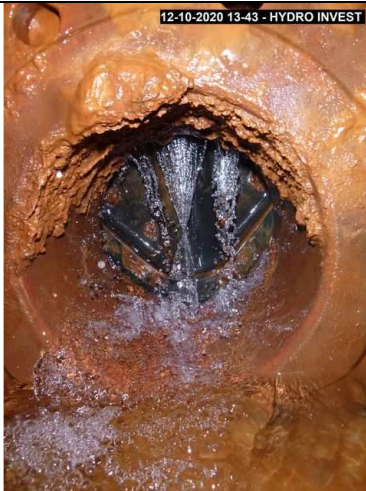
Photo N°21 Vanne d'un drain, fermée, fuyarde, corrodée et encrassée de boue ferrique
