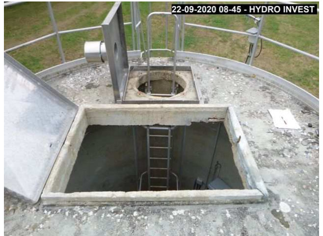
Photo N°4 Trappe rectangulaire et capot Foug au sommet du cuvelage béton. Echelle d'accès
