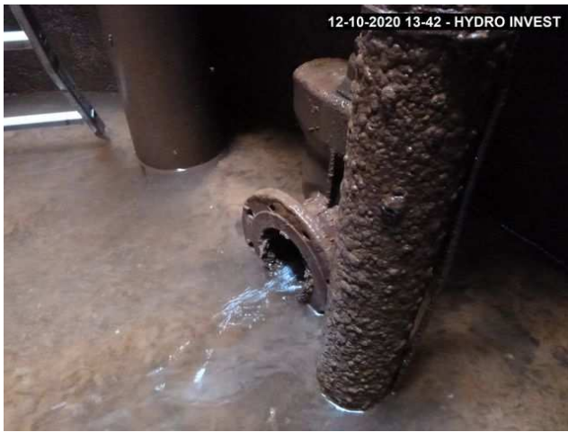
Photo N°19 Vanne fermée et fuyarde du drain N°3 Flocs de biofilm abondants au fond de l'ouvrage Corrosion marquée d'une jupe de pompe d'exploitation
