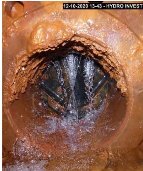
Figure 2 : Vanne d'un drain, fermée, fuyarde, corrodée et encrassée de boue ferrugineuse (Source : Etude hydrogéologique préalable aux travaux de reprise des drains du P3, HYDRO INVEST, 2020)
