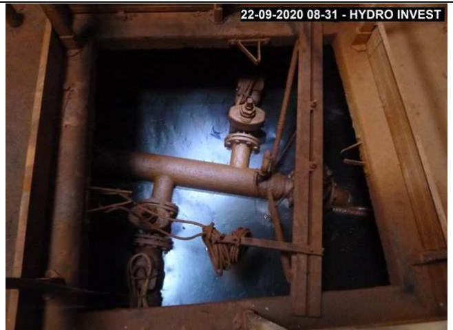
Photo N°6 Pompes d'exploitation et vannes dans le captage. Surface irisée de l'eau, signe d'une abondance en matière organique. Dépôt important de biofilm et de boue rouille.
