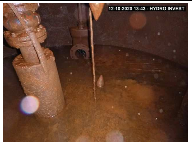
Photo N°22 Pompe avec sa jupe. Floc de biofilm abondant au fond de l'ouvrage
