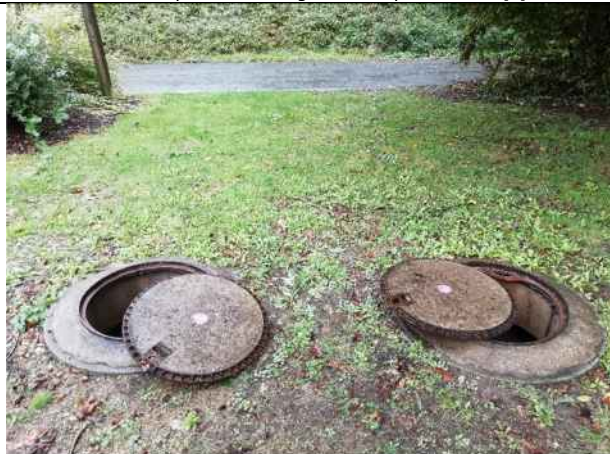
Séparateurs d'hydrocarbures, au nord du supermarché [5]
