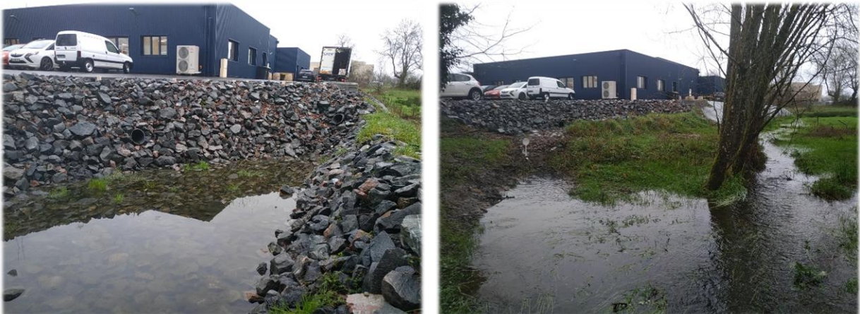
Figure 29 : Bassin tampon au niveau de la zone aménagée (Source : NCA environnement)
