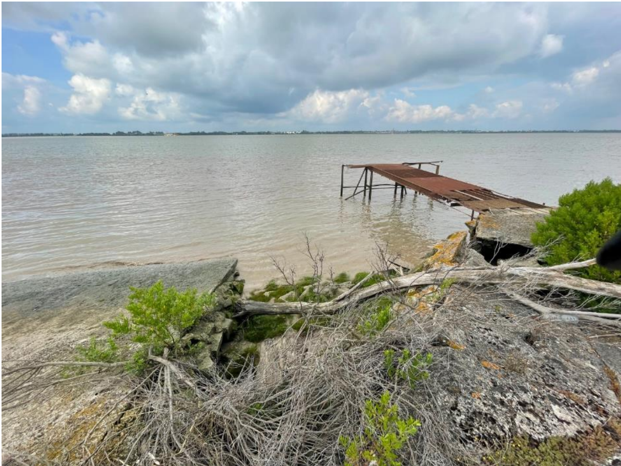
Photographie 2 du poste à péniche et de la cale inclinée à gauche
