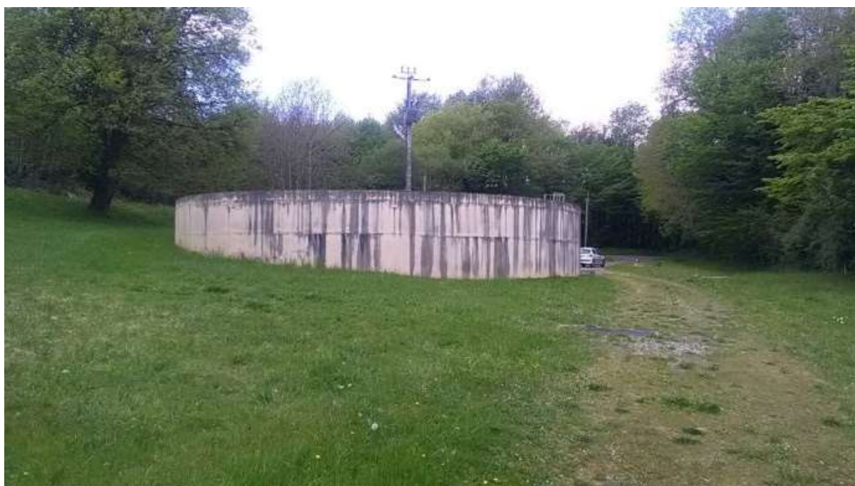
Stockage de 500 m 3 , le 29 avril 2021
