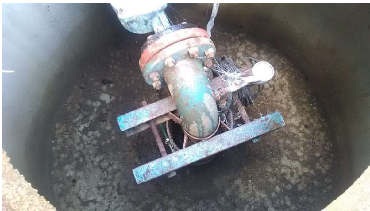
Vue à l'intérieur de la tête du forage de « La Forêt » F2, le 29 avril 2021
