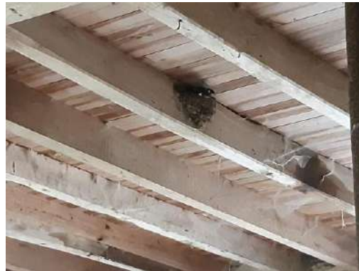
Figure 12 : Nid occupé d'hirondelles rencontrée dans la chambre d'eau de la turbine n°6.
