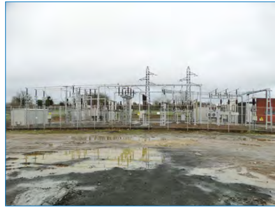
Installations électriques du poste de BOUSSAC
