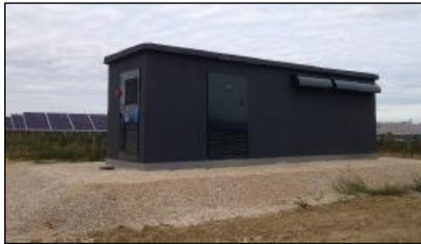
Figure 5 : Exemple de poste électrique (livraison et transformation)
