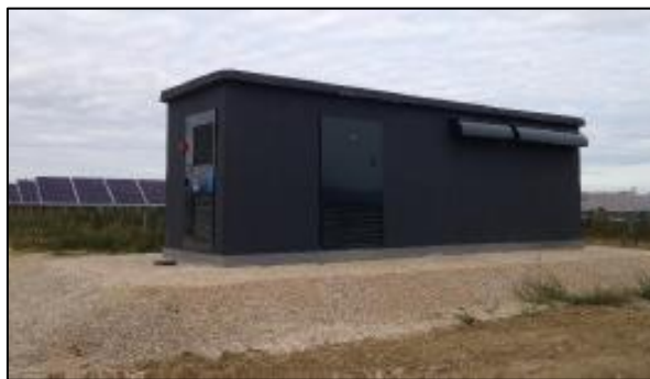
Figure 6 : Exemple de poste électrique (livraison et transformation)
