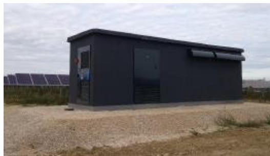
Figure 4 : Exemple de poste électrique (livraison et transformation)
