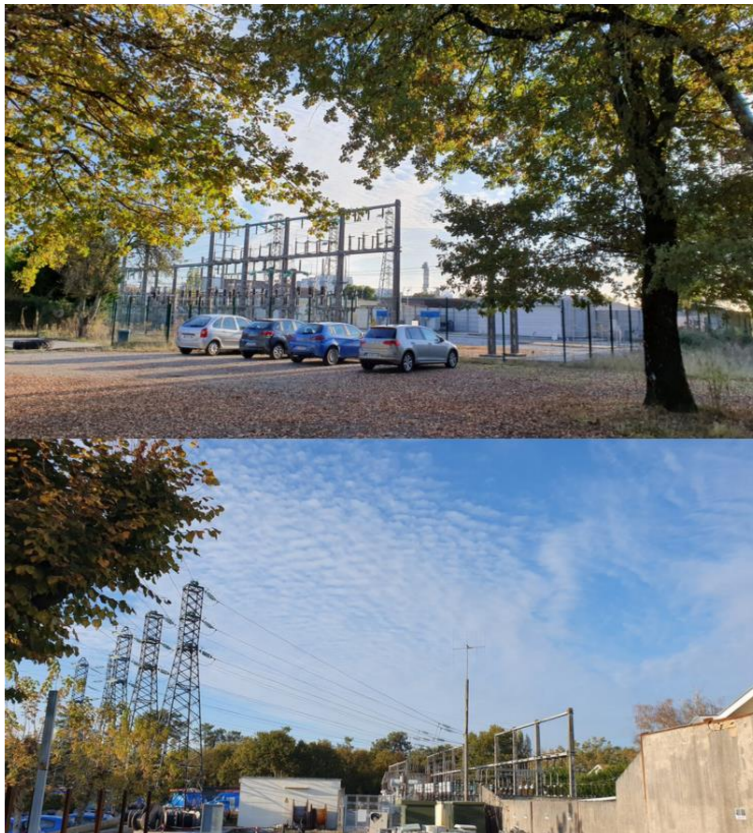
Figure 16 : Photographies du poste de Facture (Source : Iris Conseil)
