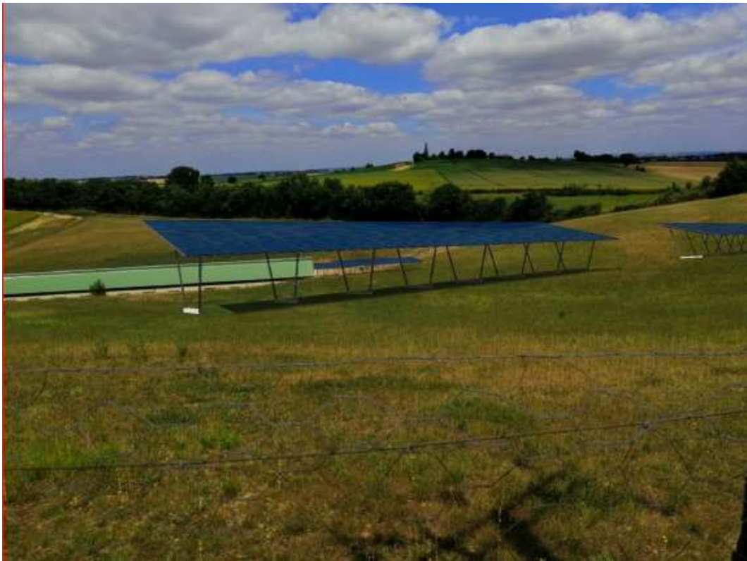
Figure 10 : Abri à volaille photovoltaïque pour parcours de volailles plein air (doc Novafrance Energy)
