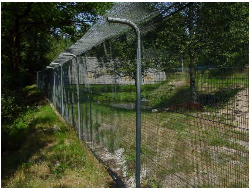
Figure 17b : Clôture de protection avec retour en partie supérieure à Bugeat (Corrèze) (S. Raimond).
