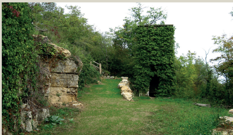
Ancien transformateur électrique de la carrière de Ricou - © Didier Poncet
