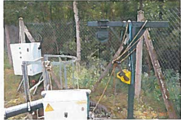
Rejet des eaux prélevées par pompage en pied de digue du Brugeaud et en amont de la digue de protection de la Gartempe (Point de prélèvement SIBPAL)
