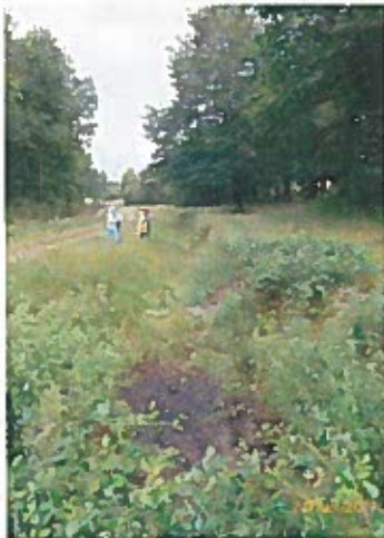
Fossé Ouest au niveau de l'ouvrage évacuateur de crue Une accumulation de végétaux a été observée entraînant la quasi-obstruction de la grille de l'ouvrage.
