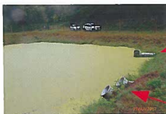
Tuyau d'évacuation des eaux de surverse vers l'avaloir
