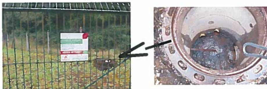
Regard de contrôle de la collecte des eaux à l'entrée du bassin (eaux d'exhaure des TMS et de ruissellement en pied de versé à stériles)
