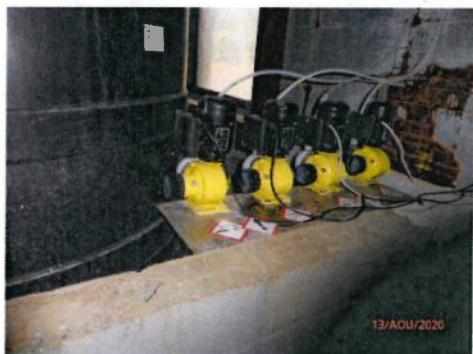
Figure 5: pompes d'injection de chlorure de Baryum (à l'intérieur du bâtiment)
