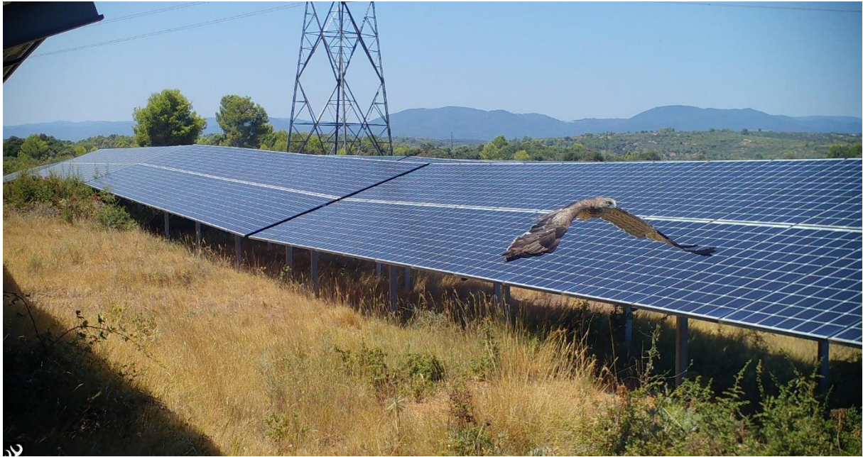
Un Circaète-Jean-Leblanc en comportement de chasse dans la centrale
