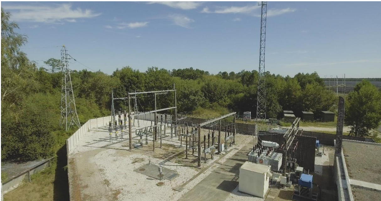
Le poste électrique d'Hostens (33)
