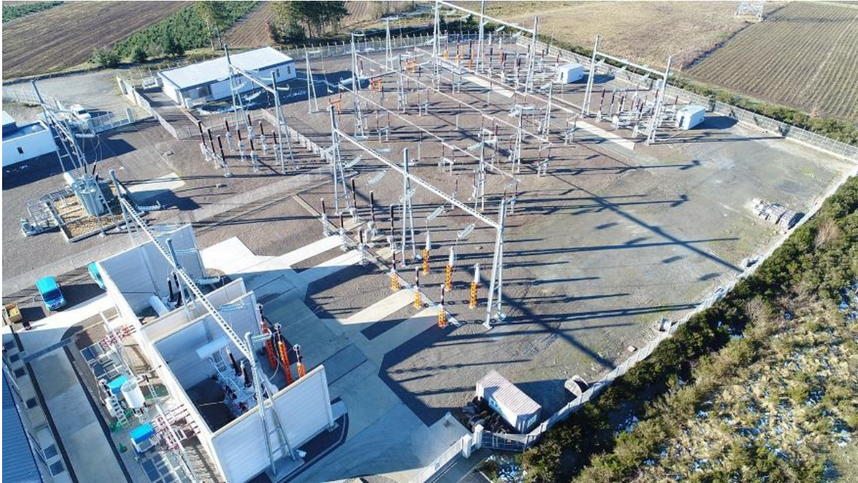
Vue d'un poste source électrique (Enedis)
