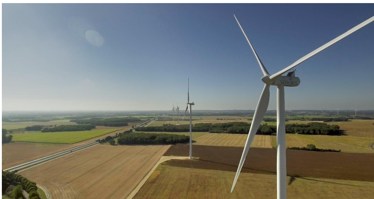
Parc éolien de Chaunay (86)
