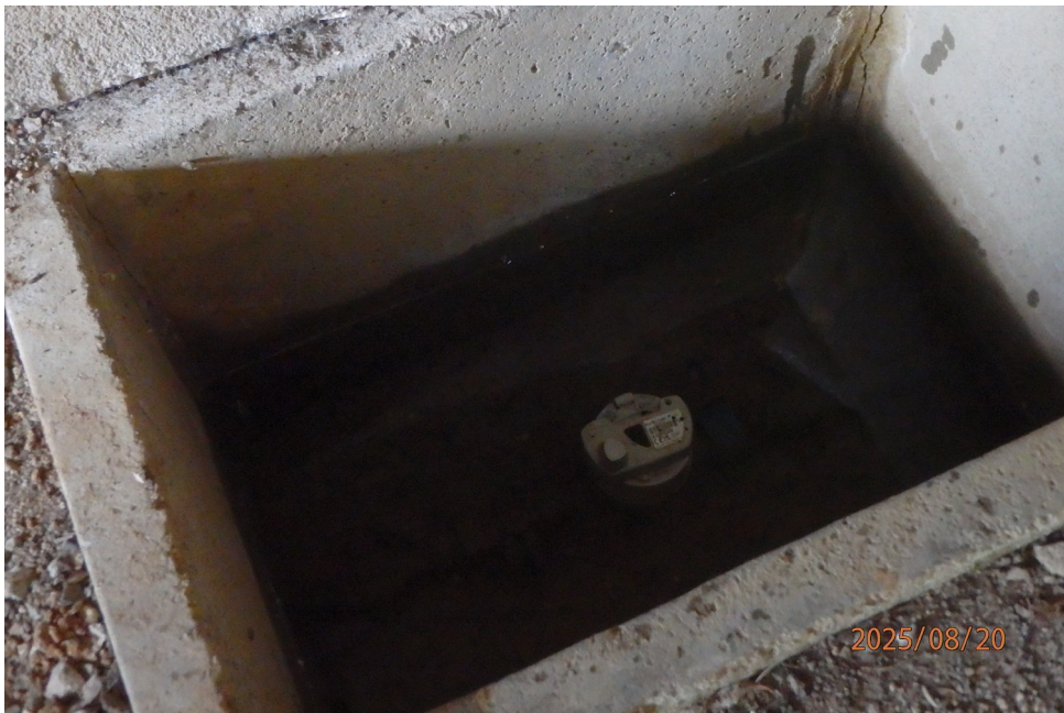
Compteur d'eau en partie ennoyé
