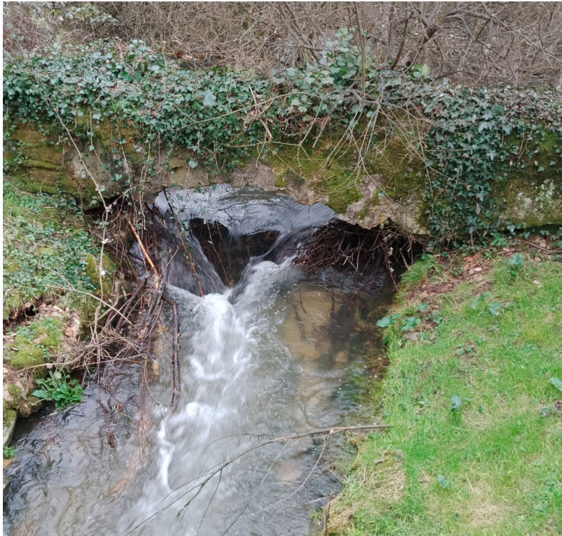
Photo barrage du pont suite à la brèche 06/02/2025
