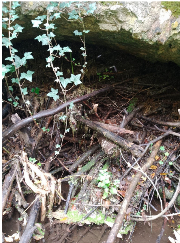
Photo du barrage du pont (complètement bouché, l'eau ne peut plus passer)
