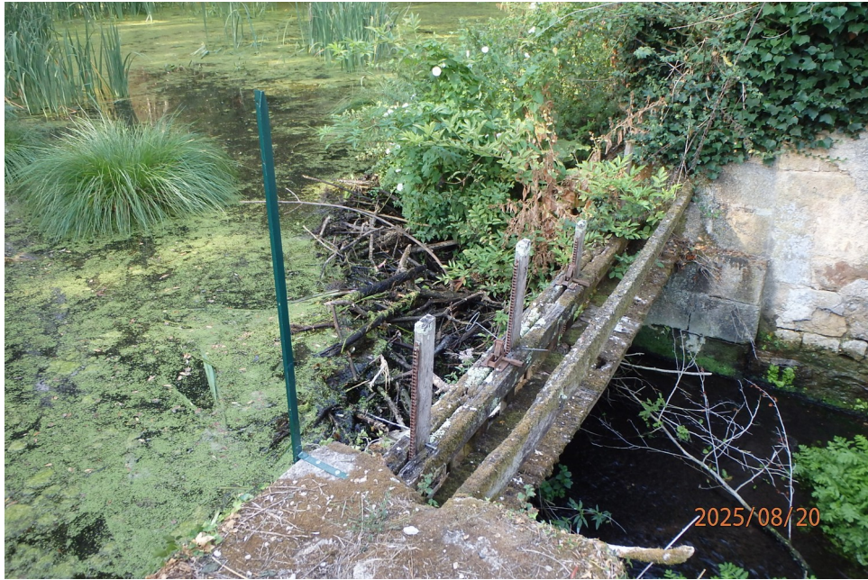
Barrage n°1 aux vannages devant la maison
