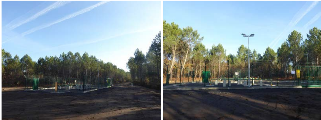
Poste de sectionnement
