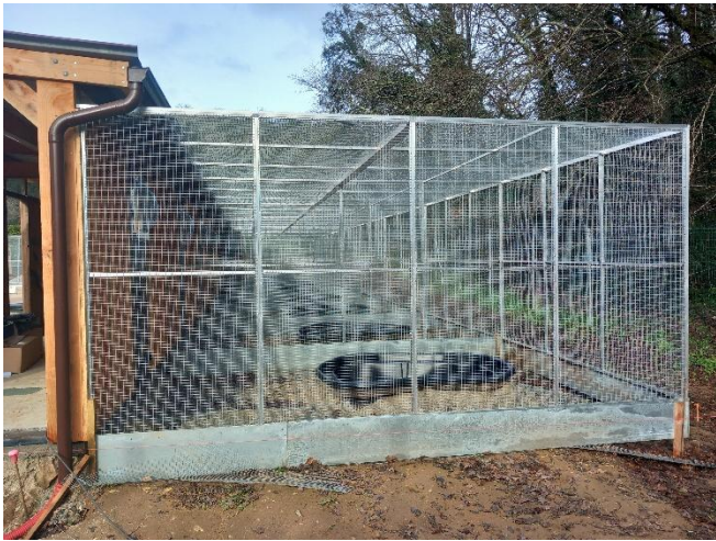
Les nouvelles installations en cours de construction à la Réserve Zoologique de Calviac (©M. FAYET - OFB)
